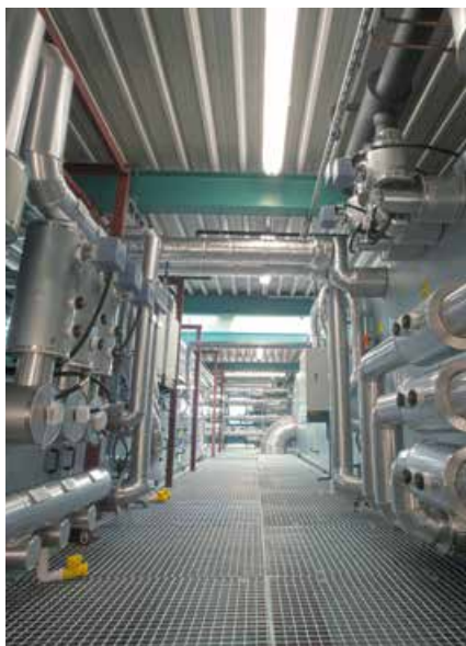
Насосные станции для системы кондиционирования
